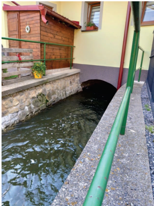
Obr. 12: Zatrubnění pod č. p. 100
