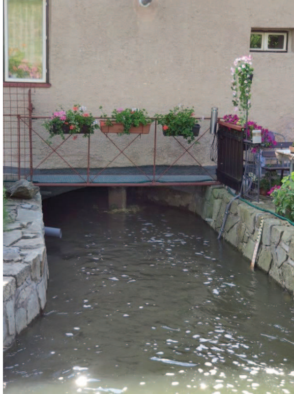
Obr. 13: Zatrubnění pod č. p. 106
